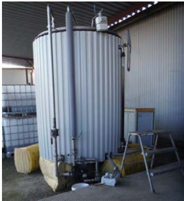
Figur 1a. Pilotrötkammare konstruerad för hybridrötning av storbal v ensilerad vitklöver.
